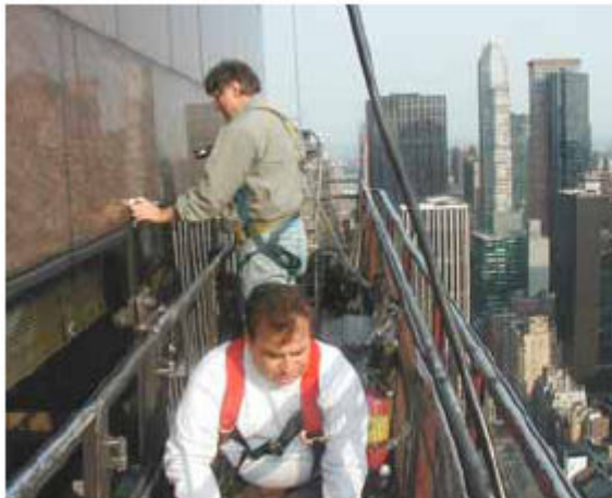
Probando la calidad del anclaje en paneles de granito En edificio de gran altura
